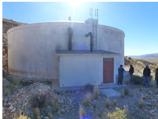
Reservorio a incorporar R-2 (Vol.: 1250 m3) - Sector II
